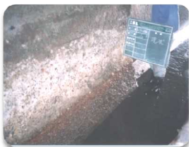
施工前 (劣化状況)
