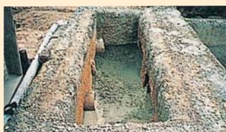
温泉水による劣化例 (源泉柵)
