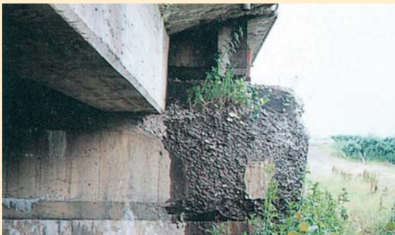
凍害による劣化例 (橋梁)
