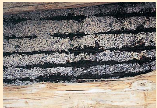
塩害による劣化例 (橋梁)
