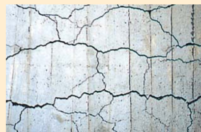
アルカリ骨材反応による劣化例 (梁)
