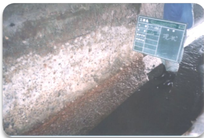
施工前 (劣化状況)
